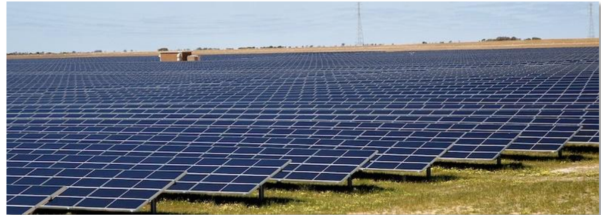
Centrale solaire sur structure fixe (source EDPR - USA)
